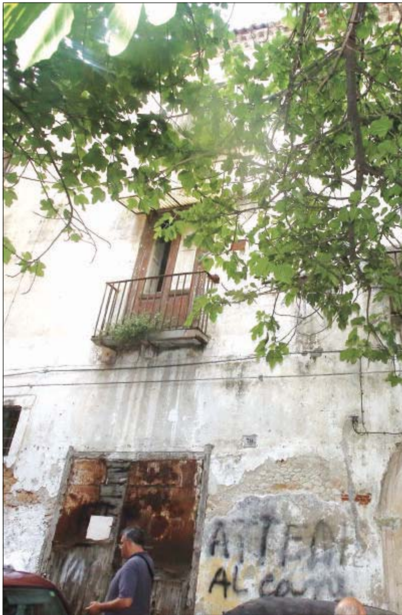
Il palazzo interessato dal crollo del solaio
